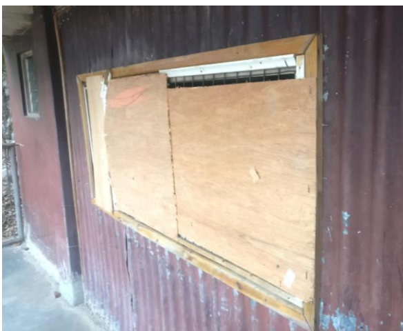
La finestra della Chocolate House è stata temporaneamente rattoppata.
